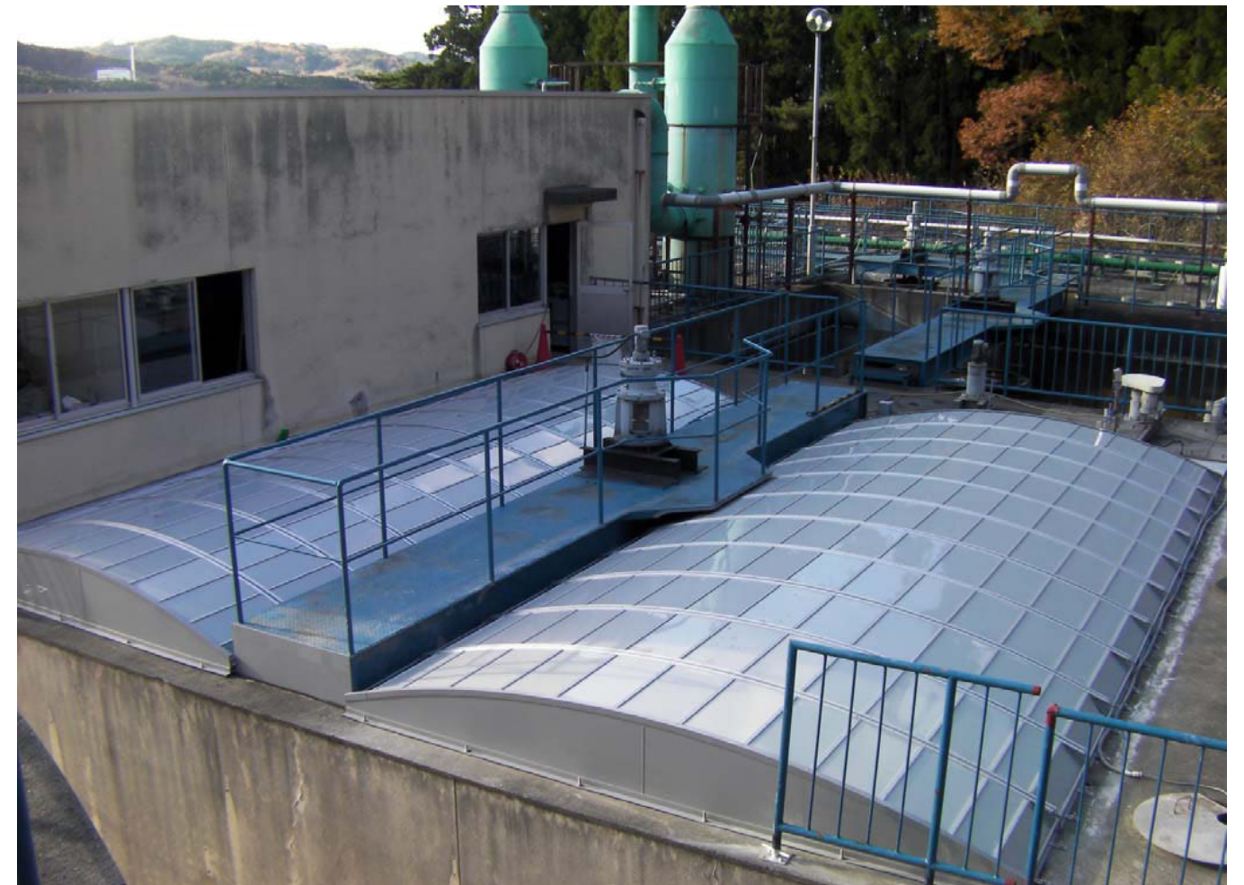
し尿処理場沈殿池に設置された「タフシールド」(2013年11月撮影)
